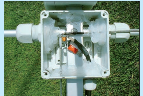
Bild 15: Anschlussdose für den Strahler mit verlöteter Phasenleitung, Koaxialkabel, Serienskondensator und Presskabelschuh
